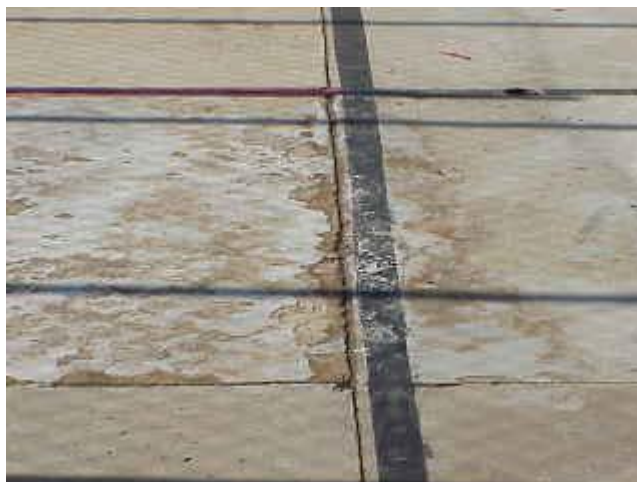
Figura 1: Visão das rachaduras na quadra da escola.
