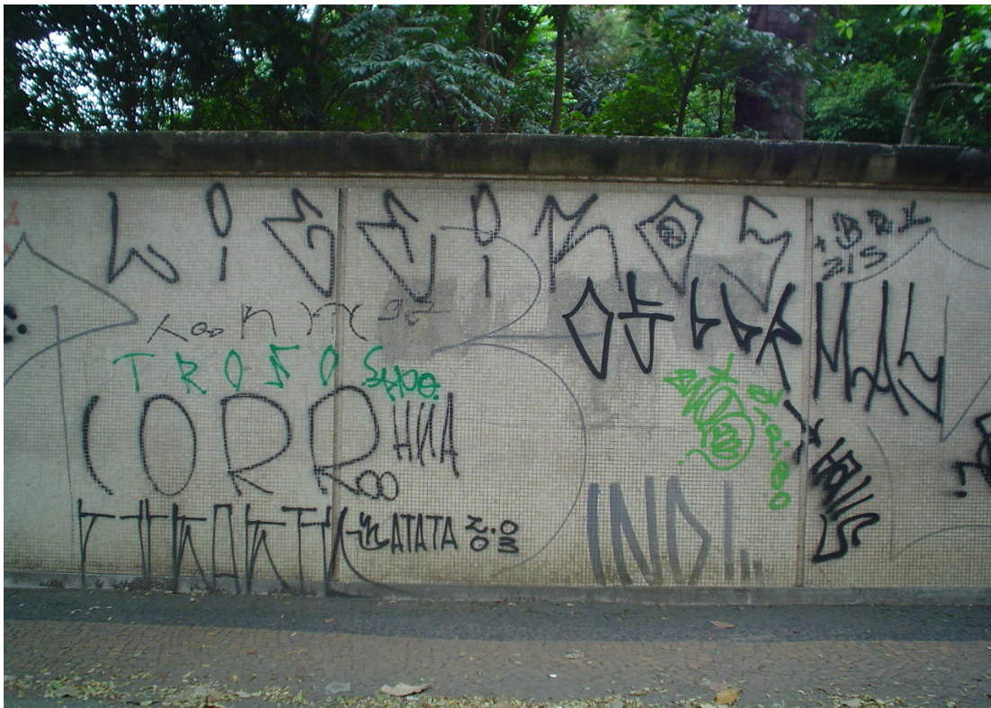
Foto 2: Diversas pixações no muro do Jôquei-Clube em São Paulo.
